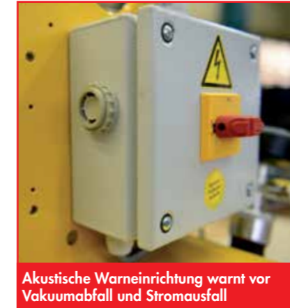
Hauptschalterüberwachung über einen Vakuum-Schalter in der Verteilerleitung
